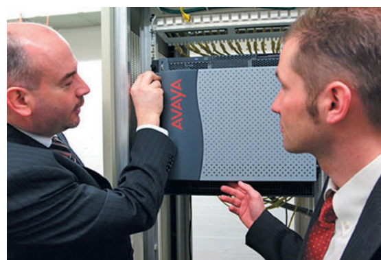
Das «Herz» der ganzen Lösung. Dank IP-Telefonie wurden die technischen Anlagen im Hauptsitz auf ein Minimum reduziert. Avaya S8500/G650
