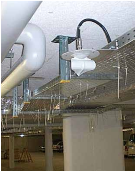
GSM/UMTS-Inhouse-Antennen gewährleisten die Versorgung in den hintersten Winkeln des Gebäudes.
